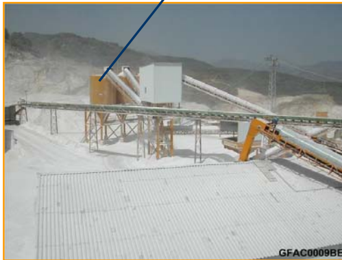
» Tolvas y silos 01
