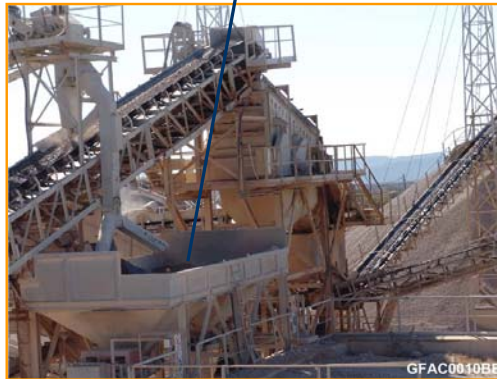
» Tolvas y silos 02
